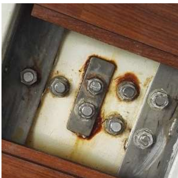
Kölbultar med misstänkt korrosion
