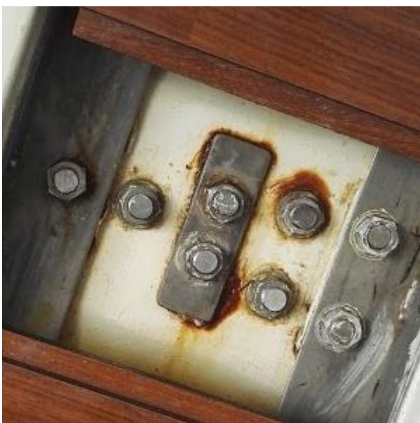
Kölbultar med misstänkt korrosion
